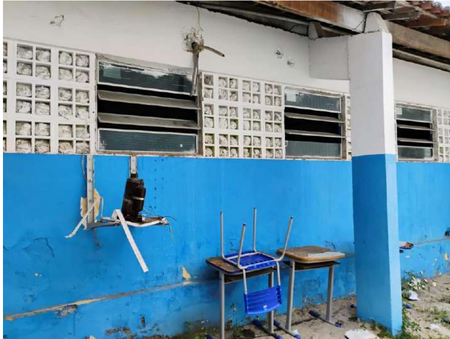
Foto 3 - Área externa de onde foram roubadas as condensadoras de ar-condicionado
